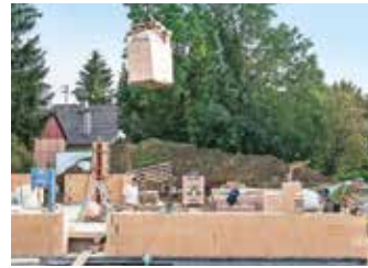
27 Und schon schwebt der Nachschub ein: Die Palette wird mit dem Kran am Einsatzort platziert.
