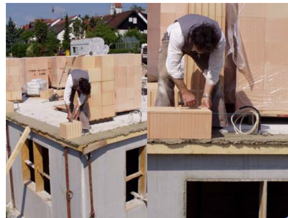
Setzen & Ausrichten; Schnur spannen & Ziegel nach dieser setzen; Ziegel nochmals mit Wasserwaage & Gummi- hammer ausrichten
